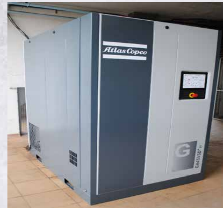
Adquisición de un nuevo sistema de aire comprimido (generación y transporte) para los talleres de nitración y torre concentración de ácidos
