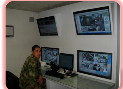
Figura No. 4- 25. Circuito cerrado de televisión
