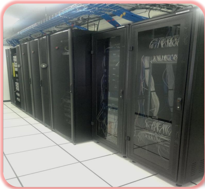
Figura No. 4- 14. Centro de computo Oficinas Centrales
