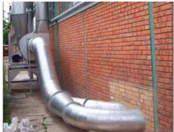
Sistema de extracción de emisiones
