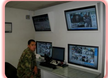
Figura No. 4- 25. Circuito cerrado de televisión
