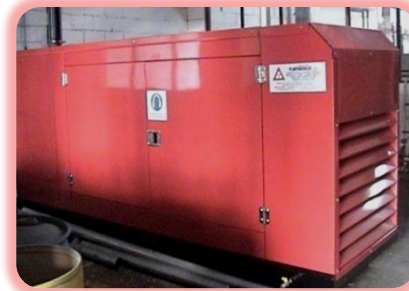
Figura No. 2- 46. Planta eléctrica
