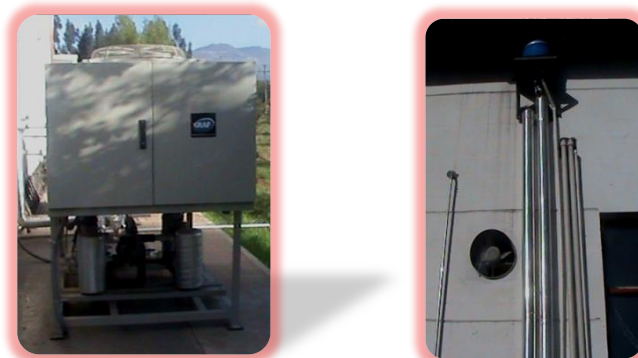
Figura No. 2- 41. Sistema de refrigeración para placas de enfriamiento
